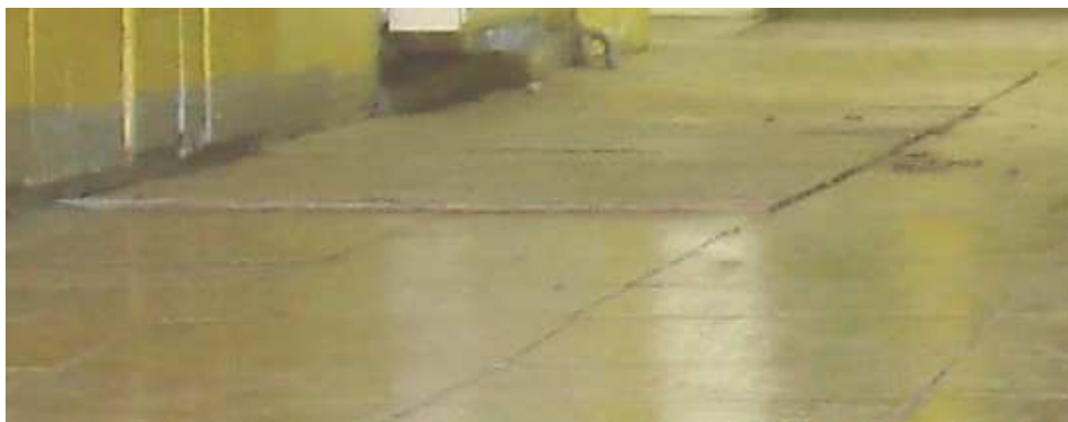
2.att. Grīdas līmeņu starpība 1.stāva gaitēņa grīdā
