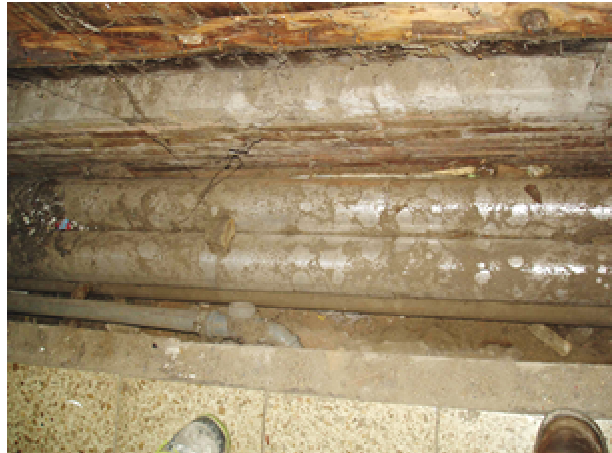
18. att. Sadalošie cauruļvadi kanālā uz ēdināšanas bloku ar izolāciju
