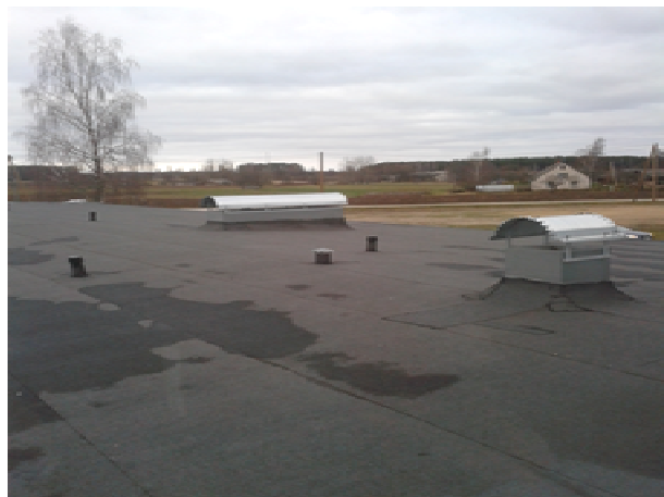
29.att. Ventilācijas izvadi virs jumta.
