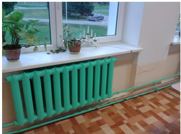
20. att. Čuguna sekciju radiators.
