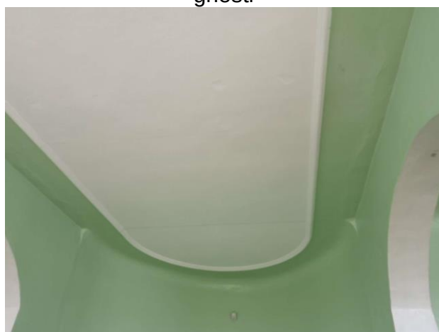
4.18.12 kvalitatīvi griesti virs kāpņu telpas
