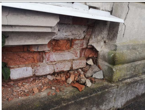
4.1.10 bojāts cokola ārējais apmetums
