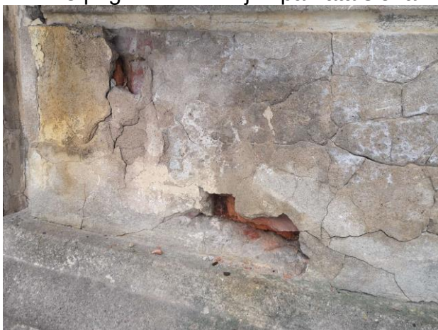
4.1.5 bojāts cokola ārējais apmetums
